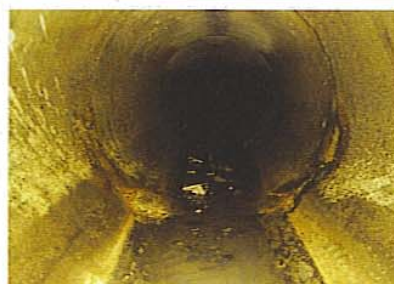
Antes da recuperação: trincas e infiltrações
